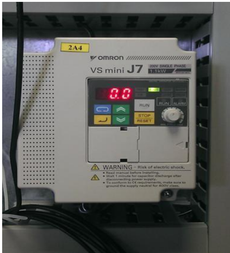
Рис. 8.5. Силовой трёхфазный инвертор
