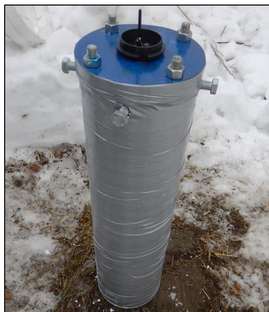
Рис. 5. Наблюдательная скважина № 49, оснащенная приборами levellogger и barologger с телеметрической передающей станцией LevelSender 9500
