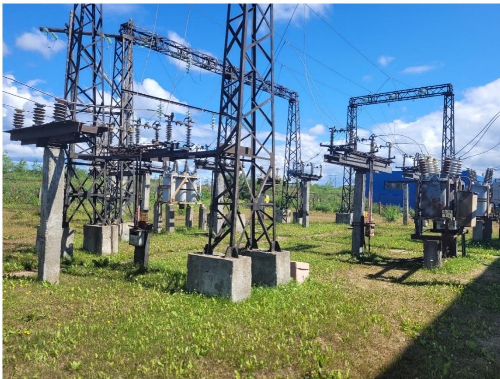
Рис. 3. Трансформаторная подстанция 35/6 кВт
