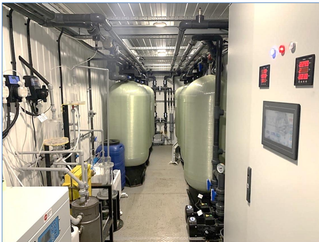
Рис. 2. Технологическое оборудование станции «БМВО-10»
