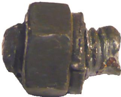
Рис. 3. Характерные повреждения от температурного расширения
