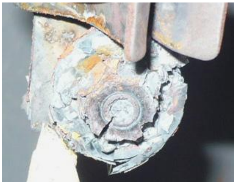
Рис. 1. Разрушение соединения под действием температуры
